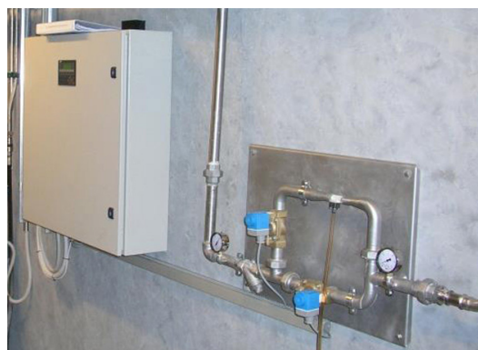
Painel de controle Unidade de limpeza CIP automática.
