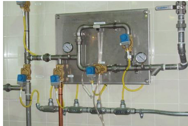
Sistema de limpieza automático.
