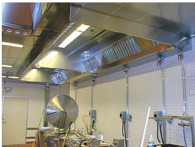
-Udsugningsanlæg med fedt- og olie-rester fra køkkener kan være de rene brandfælder, men vores systemer nedsætter denne fare betydeligt, siger Jimmy K. Larsen
