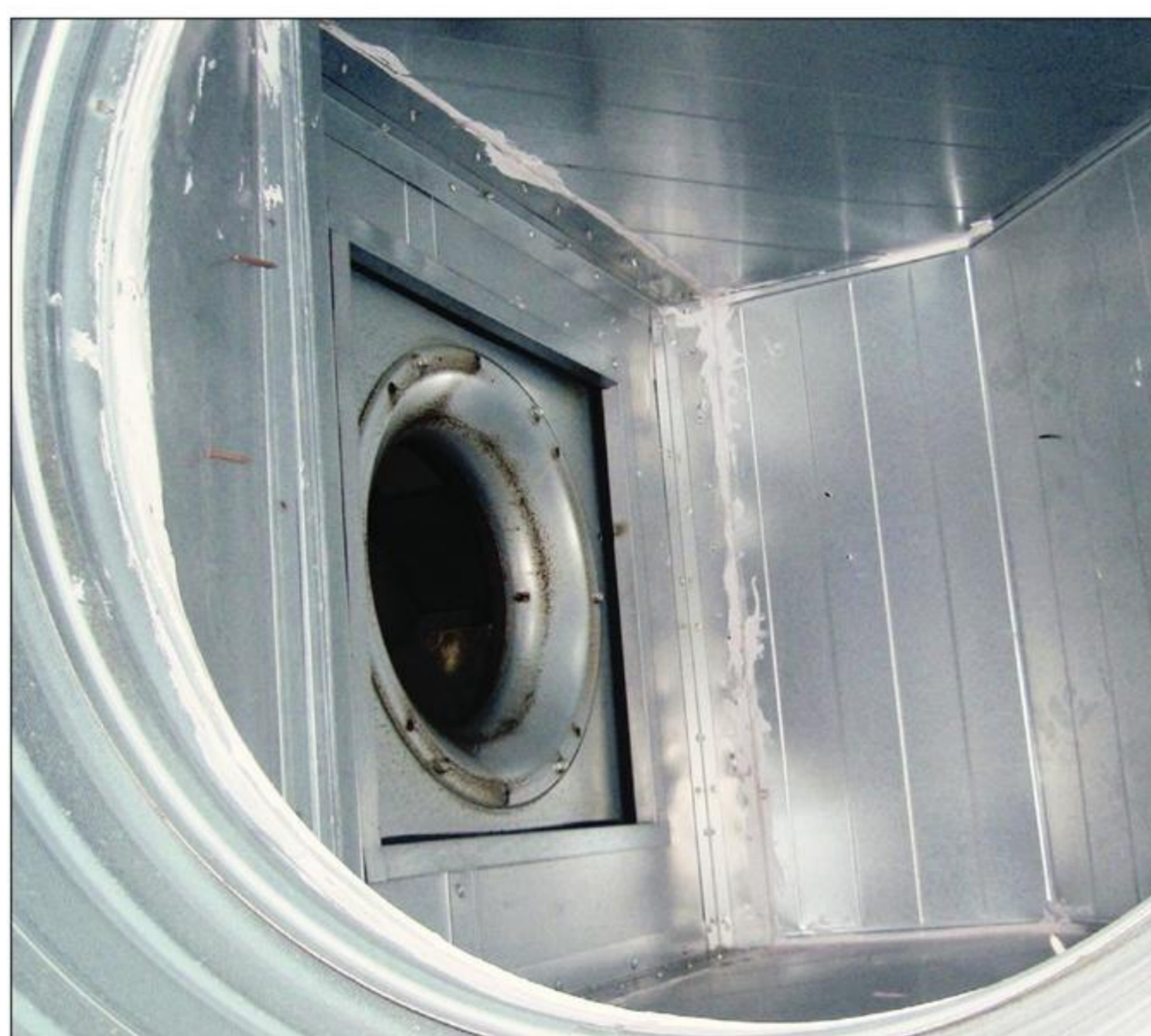
Aflejret fedt i emhætter og ventilationsrør kan være en årsag til brande.
