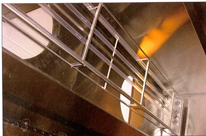
Brandsikkerheden er øget i de Bones restauranter, hvor anlægget er installeret - det giver et ekstra kort på hånden overfor forsikringselskaberne, når der skal forsikres mod brand.
